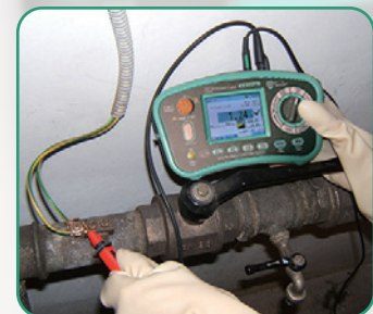
Comprobación de continuidad de unión equipotencial
